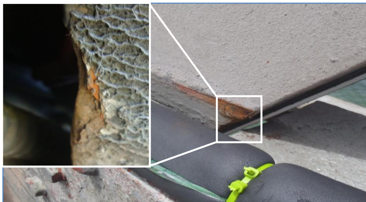
Εικόνα 7: Φθορά λόγω τριβής
